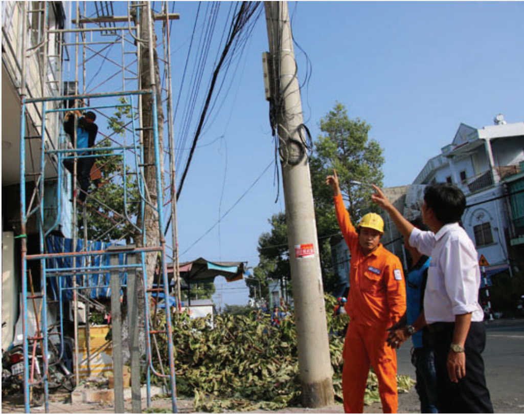
Nhân viên Điện lực hướng dẫn người dân xây dựng công trình đảm bảo an toàn hành lang lưới điện cao áp
