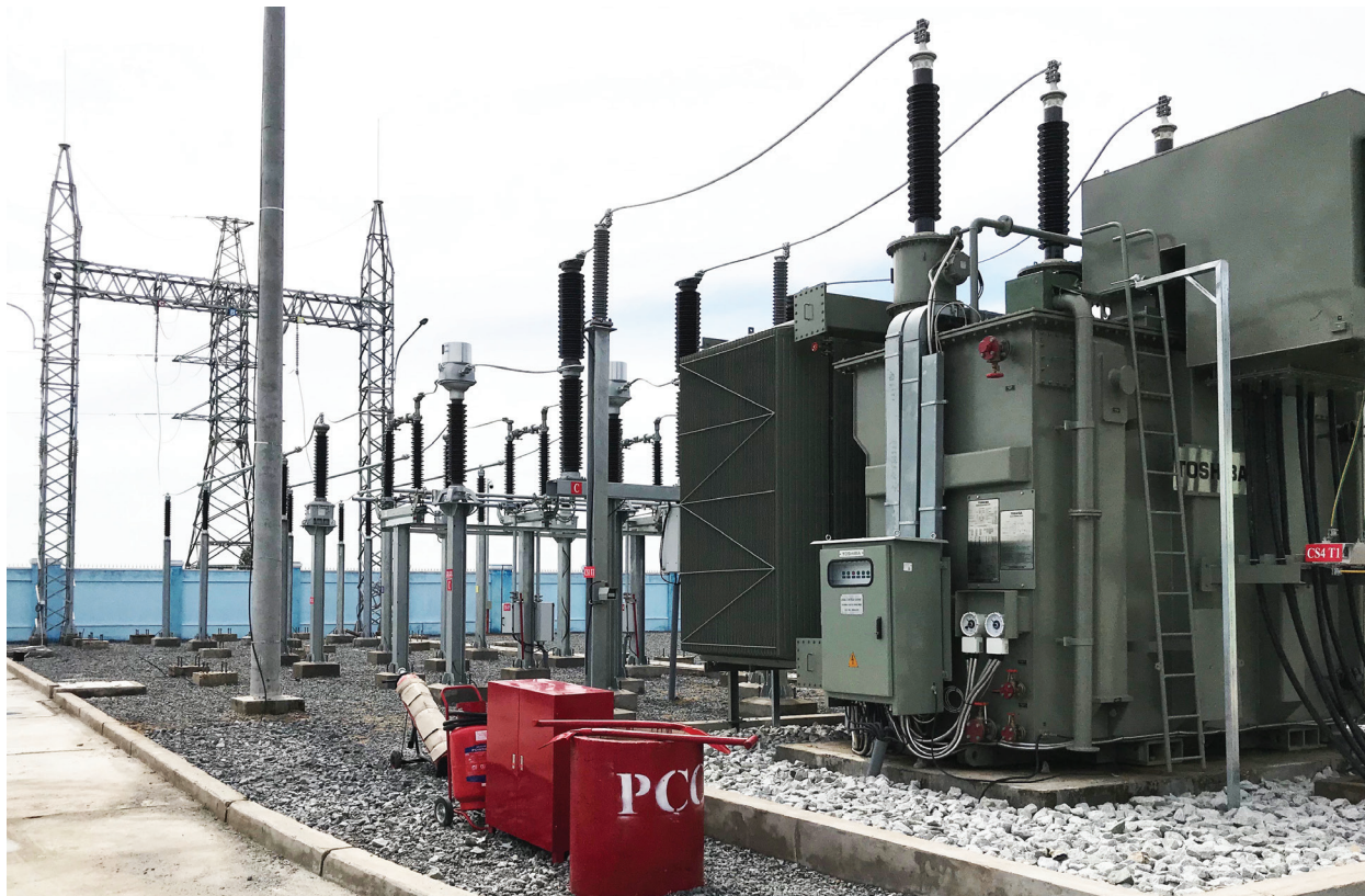
Trạm 110kV Tam Nông, tỉnh Đồng Tháp
