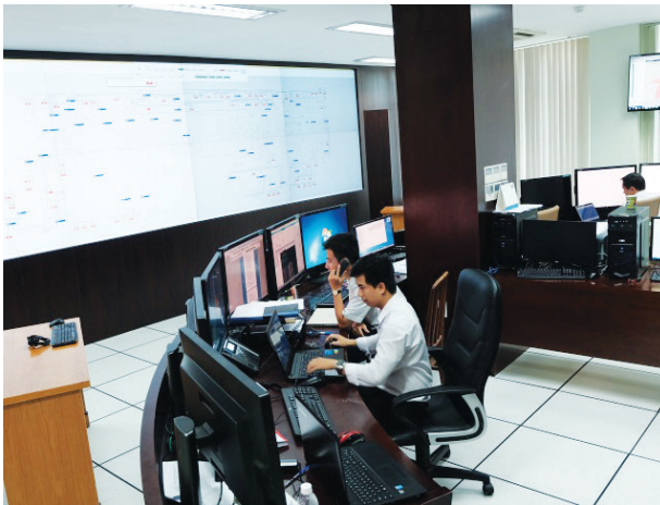
Trung tâm điều hành Scada của EVN SPC
