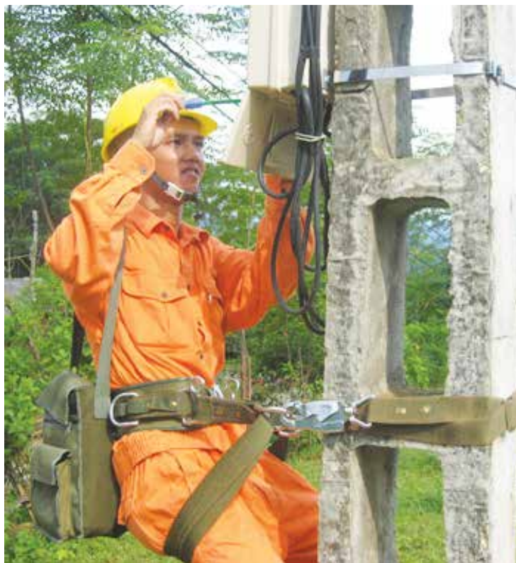
Công nhân Điện lực kiểm tra công tơ điện cho hộ dân
