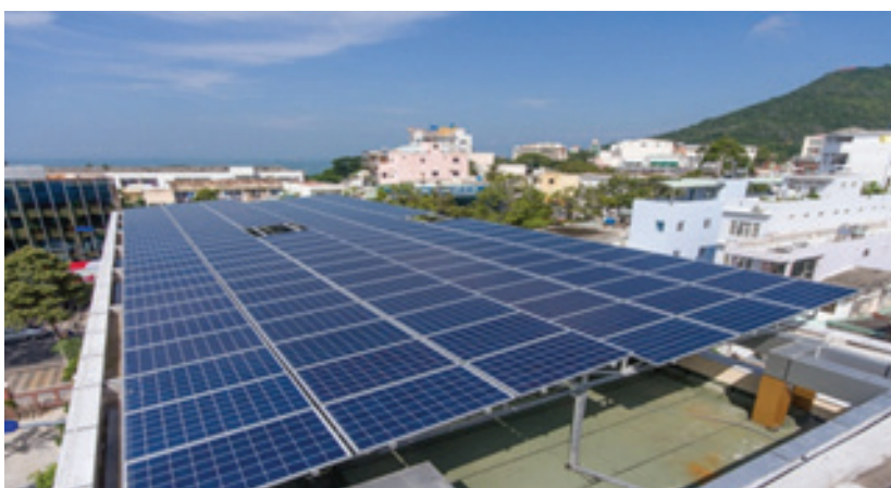
Hệ thống pin năng lượng mặt trời trên nóc tòa nhà PC Bà Rịa - Vũng Tàu
