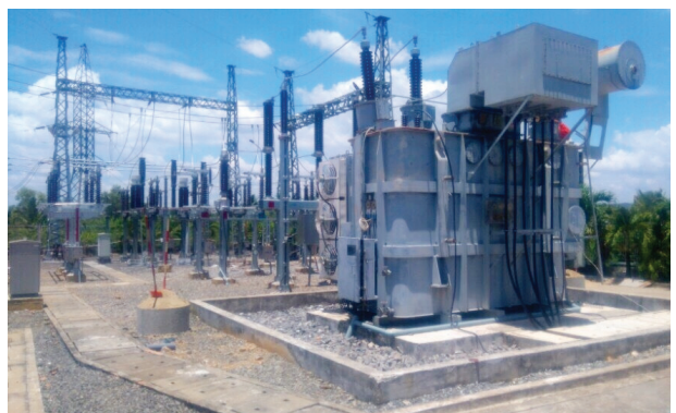
Trạm biến áp 110kV Tân Phú.
