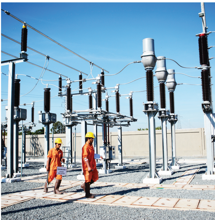
Các công trình lưới điện sớm đưa vào sử dụng sẽ nâng cao độ tin cậy cung cấp điện
