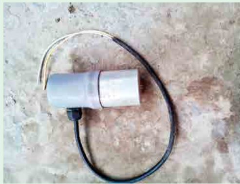
Tụ bù bị bể nắp sau khi áp dụng giải pháp
