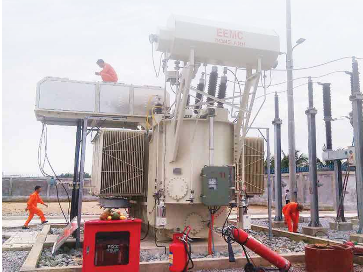
Trạm 110KV Sông Đốc
